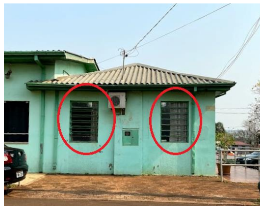
Figura 14: Janelas a serem substituídas.
