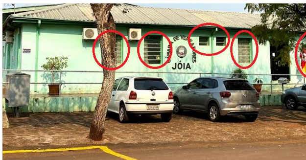
Figura 13: Janelas a serem substituídas.
